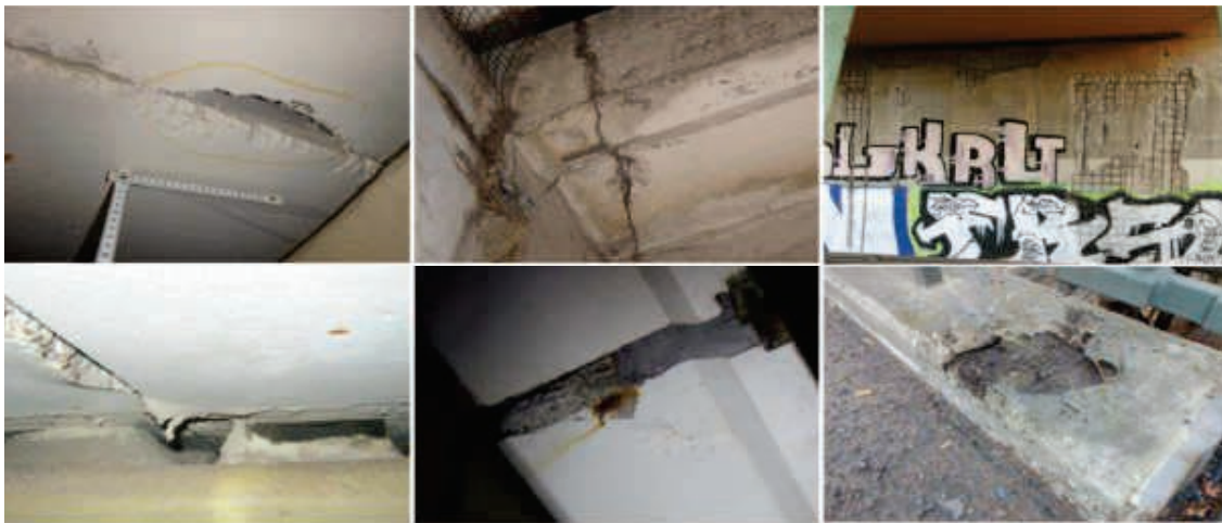
Abb. 8 - Typische Schadensbilder an Brückenbauwerken, z. B. Spannbetonbrücken, Quelle: © SenMVKU
